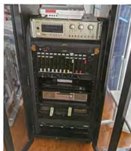
ホール音響設備の部分替
